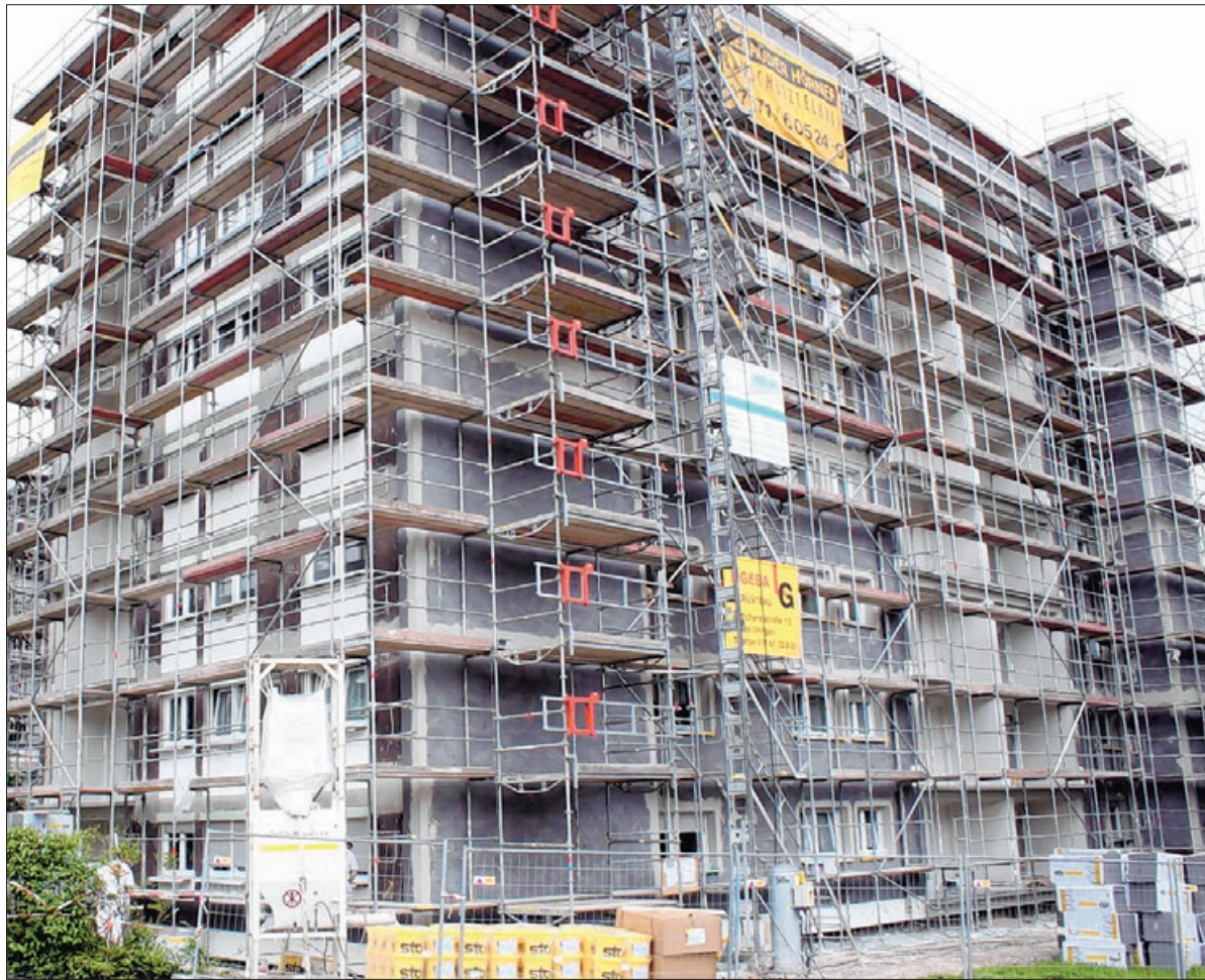
Bis Oktober dauern voraussichtlich noch die umfassenden Sanierungsarbeiten der beiden Wohngebäude im Ursenwanger Ulmenweg 4 und 6. Insgesamt 3,3 Millionen Euro investiert hierfür die „Flüwo Bauen Wohnen eG“. Foto: Staufenpress
