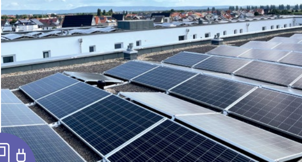
Hockenheim, Wilhelm-Herz-Straße, Photovoltaik-anlage für das Pflegeheim
